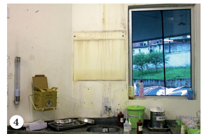
1. Área externa da Unidade de Pronto Atendimento; 2. Cadeira para atendimento em péssimas condições; 3. Lençóis sujos e ensacados por mais de seis meses; 4. Mofo nas paredes e próximo aos materiais para procedimentos
