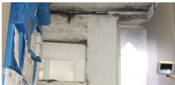
Instalações precárias chamaram atenção da fiscalização
