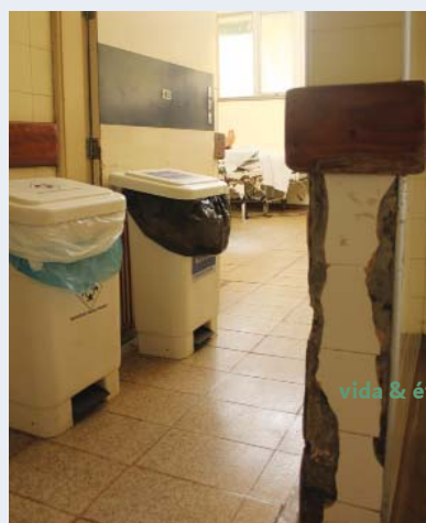
Paredes e portas precisam de reparos
