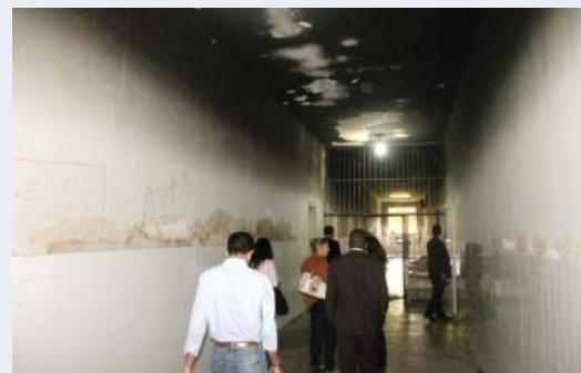
As manchas do incêndio de abril de 2013 permanecem nas paredes
