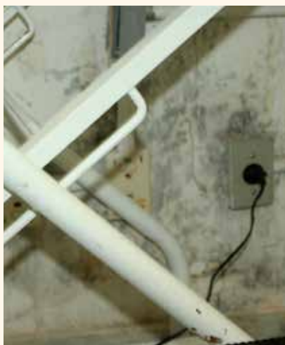
Nos cômodos da USF da Gamboa há mofo e infiltração
