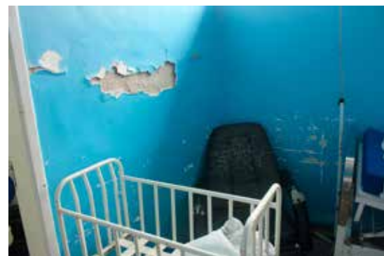
Na Albert Sabin problema com a refrigeração e manutenção de leitos reduziu atendimentos
